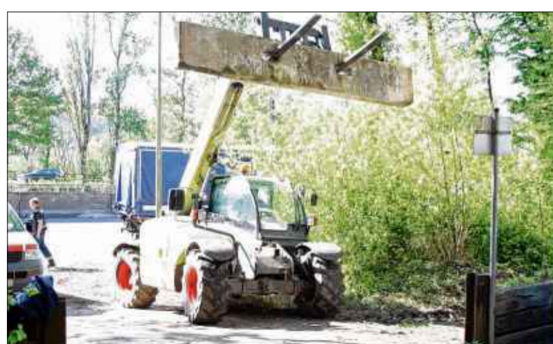
Mit einem Gabelstapler mussten die Betonelemente abgebaut werden, die normalerweise den Eingang verschließen. Foto: pr
